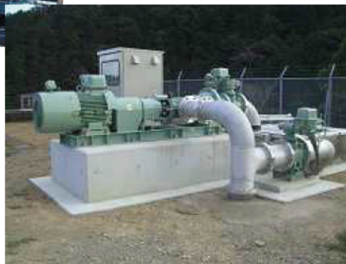
小水力発電設備
