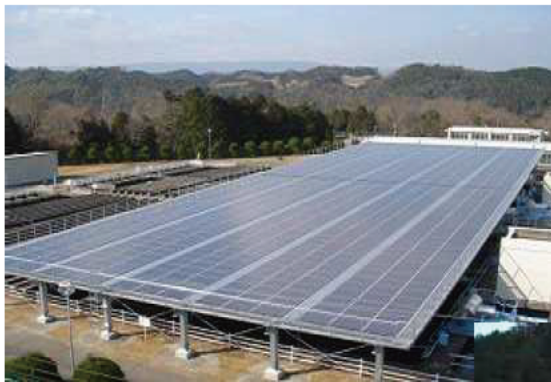
太陽光発電設備
