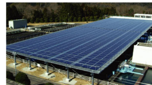
高野浄水場太陽光発電設備(津市)
