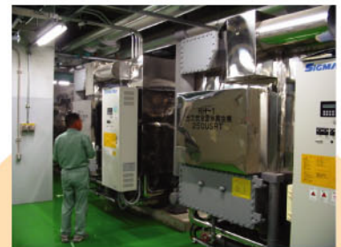
冷温水発生機（本庁）
