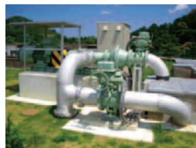
磯部浄水場小水力発電設備
