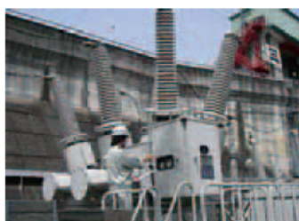
変電設備の点検
