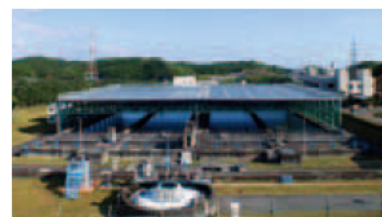
播磨浄水場太陽光発電設備（桑名市）
