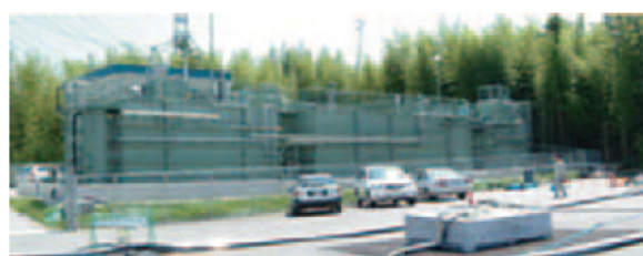
行政代執行による支障等の除去 （有害な産業廃棄物による汚染地下水の浄化施設）
