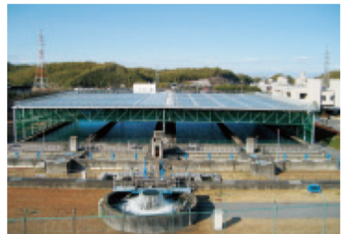
播磨浄水場太陽光発電設備(桑名市)
