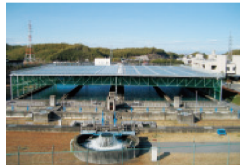
播磨浄水場太陽光発電設備(桑名市)
