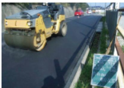
再生アスファルト合材を用いた道路舗装 【鈴鹿建設事務所】（鈴鹿市）
