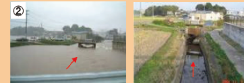
相川橋の浸水(左:出水時 右:通常時)
