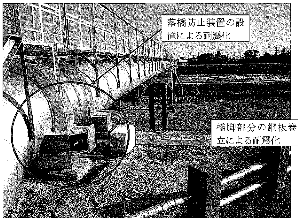
耐震化対策を行った三滝川水管橋(三期)施設〔平成20年度完成〕
