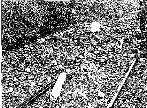
コルゲートパイプからの流入土砂
