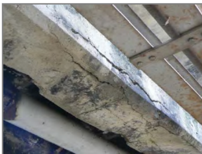
< ひび割れの様子(橋梁) >
