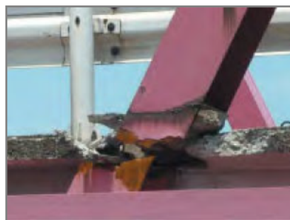
< 破断の様子(橋梁) >
