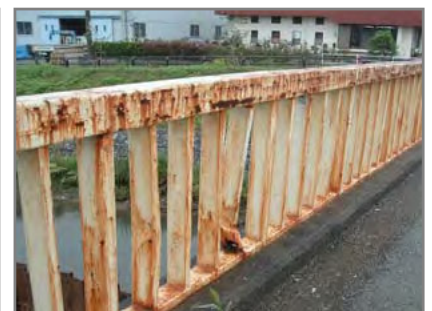
< 高欄の腐食(橋梁) >
