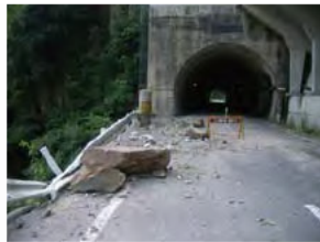
＜県境付近で落石が発生した 名張曾爾線(H20)＞
