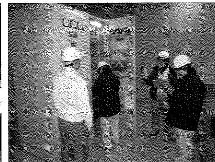
電気設備点検業務
