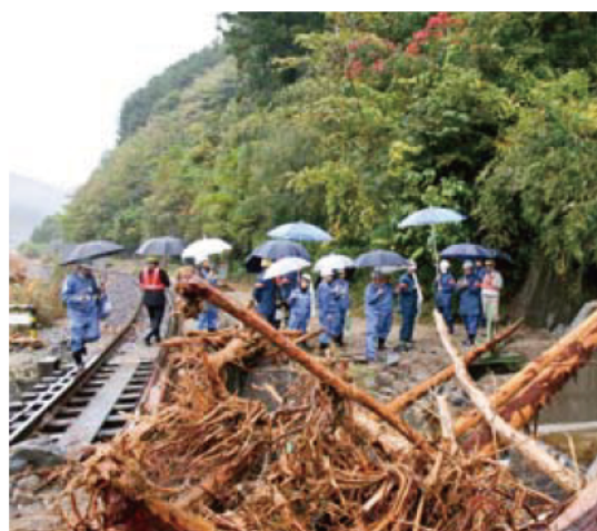
JR名松線の被害状況の現地調査 (平成21年11月11日)※記事は6ページに掲載しています。
