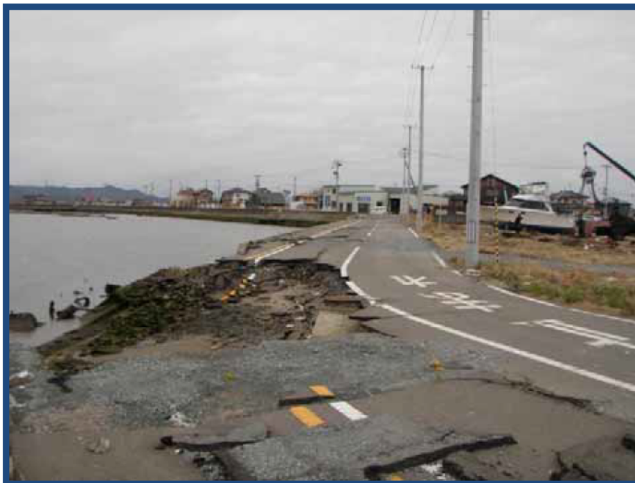
○震災により崩れた道路（巨理町） H24年4月20日撮影
