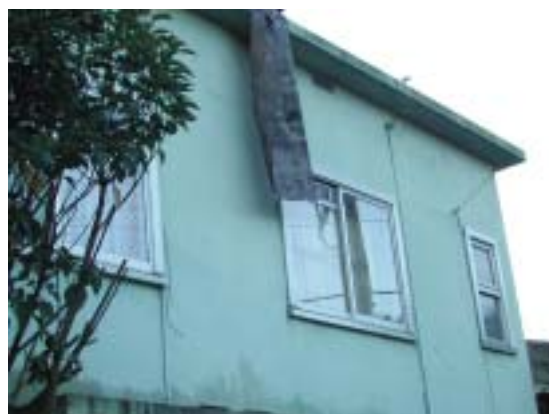
(屋根の一部のシートが剥がれている棟)
