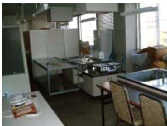
(写真2-⑩ 厨房器具が放置されたまま3階倉庫として扱われている部屋)
