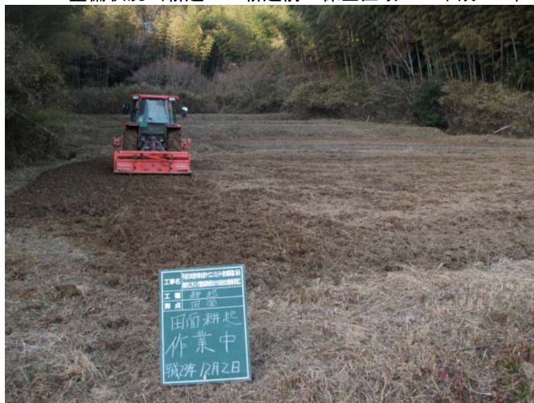
写真4-3-24 整備状況（耕起工：耕起作業中・保全区域A：平成23年12月2日）
