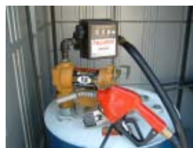
給油ポンプ（三重県庁）
