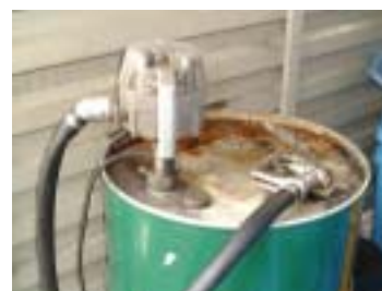
給油ポンプ（魚国総本社三重支社）
