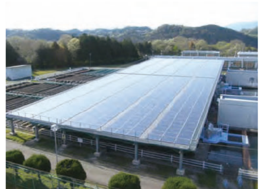
太陽光発電設備（高野浄水場）
