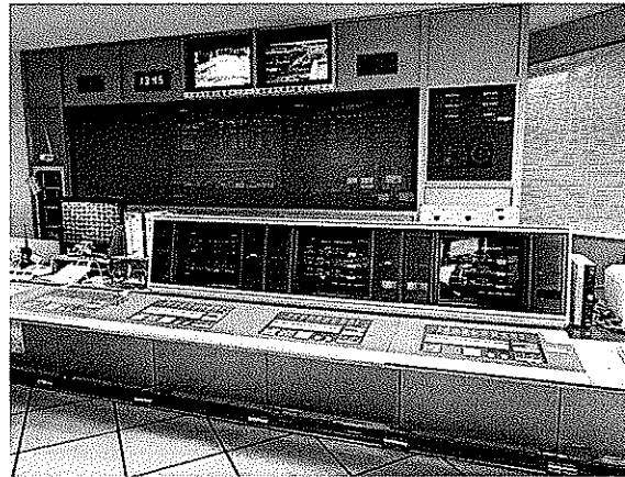
改良予定の設備機器 (高野浄水場中央監視制御設備)
