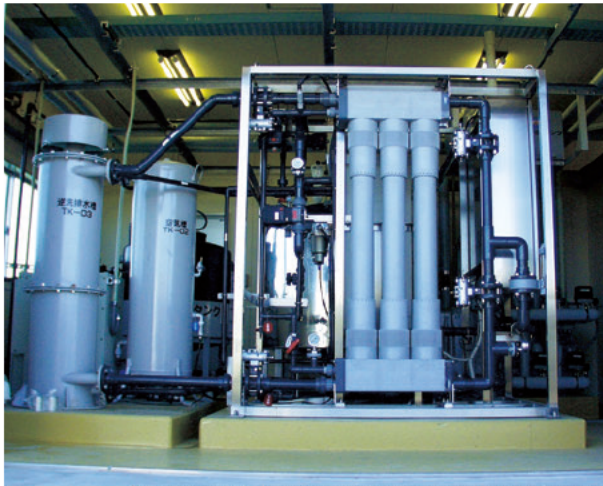
写真3 海水をろ過する装置
