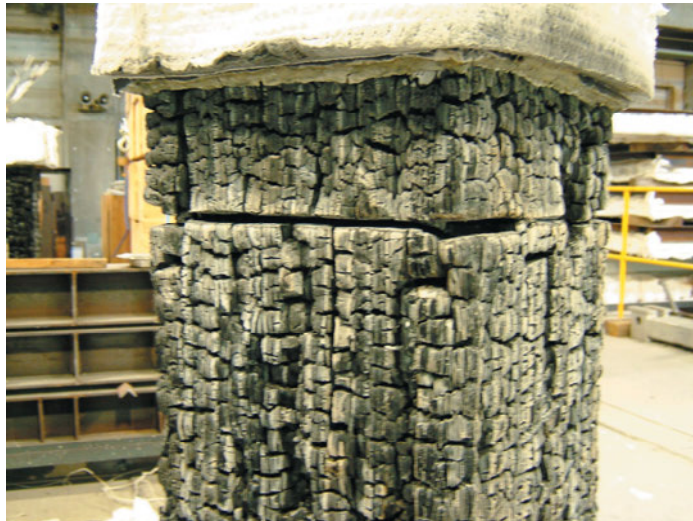
写真-7. 接合部炭化収縮の状況
