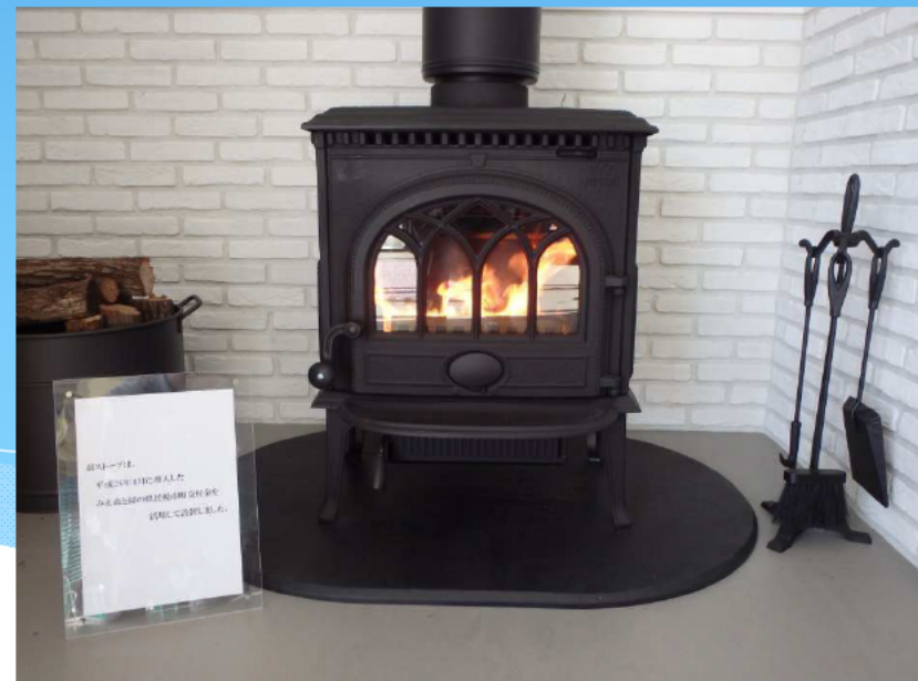
薪ストーブ設置状況
