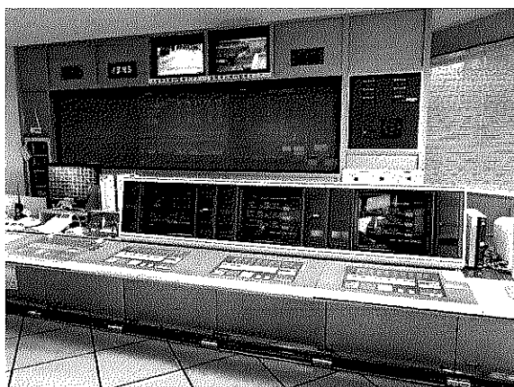
改良予定の設備機器 (高野浄水場中央監視制御設備)
