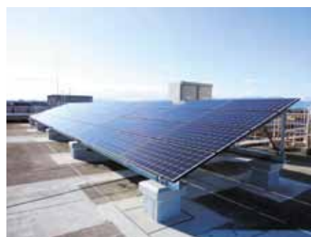
太陽光発電設備
