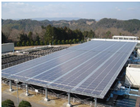
【太陽光発電設備】
