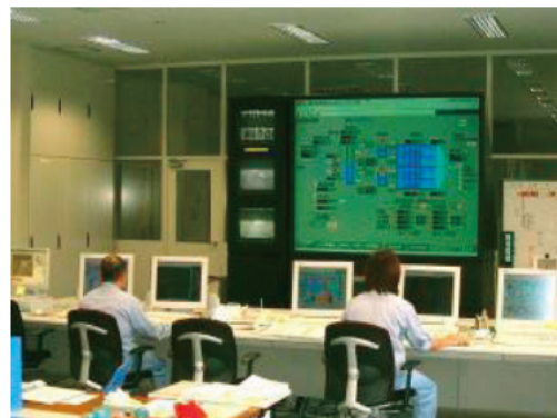
民間委託による運転監視
