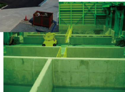
RDF貯蔵ピット
