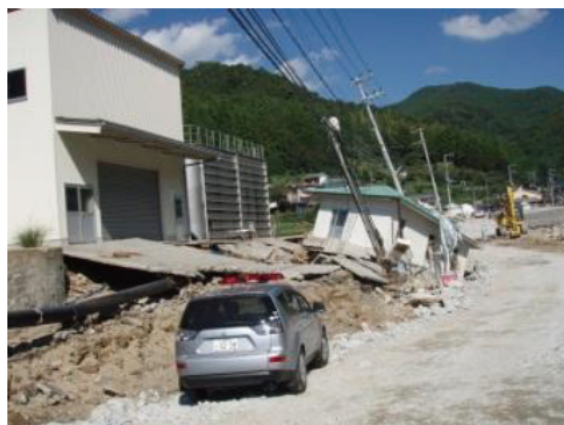
【浄水施設の被災状況(熊野市)】
