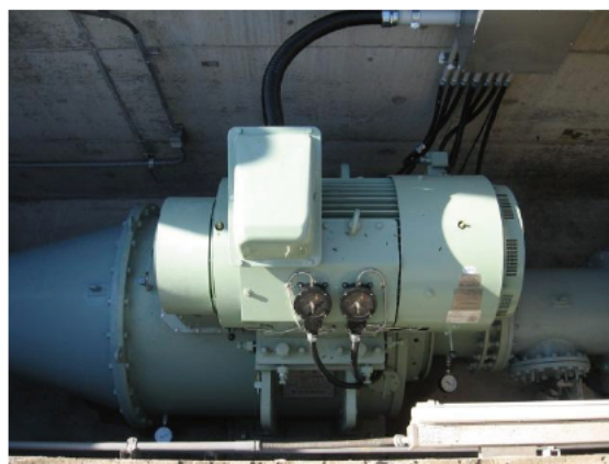
【小水力発電設備】
