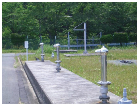
【震災時の応急給水拠点】
