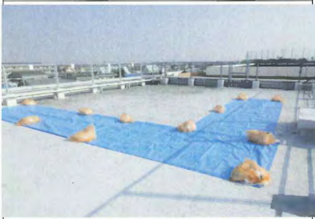
【桑名市 伊曾島小学校】 緊急サインの表示
