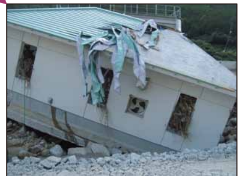
【参考】平成 23 年台風 12 号により被災したポンプ室（熊野市）
