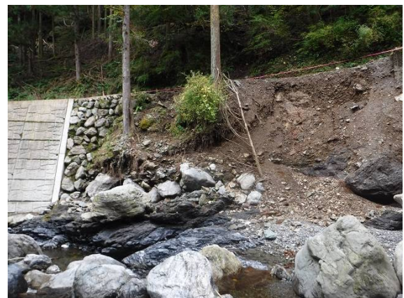
林道滝頭線 被災状況 (大台町)
