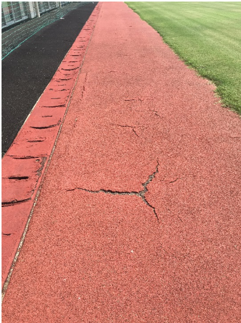
ひび割れが生じている舗装
