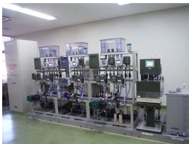
多気浄水場水質計測設備の設置状況 (平成28年度更新)
