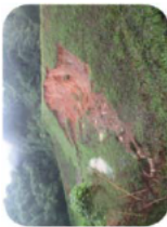
ため池堤体の被害
