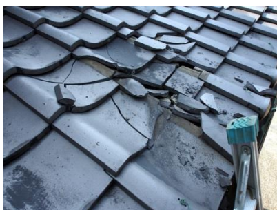
猿に壊された屋根瓦
