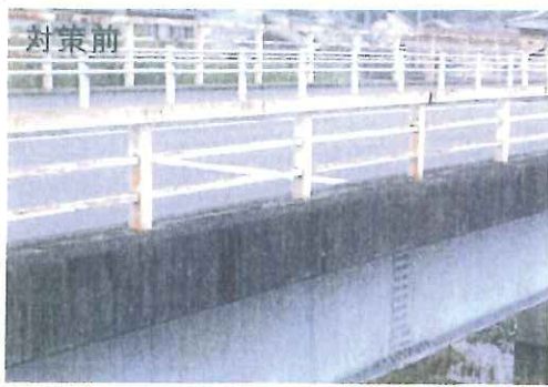
老朽化により高欄、主桁のサビが進行
