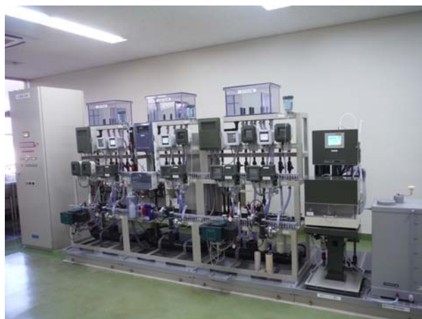
多気浄水場水質計測設備の設置状況 (平成28年度更新)
