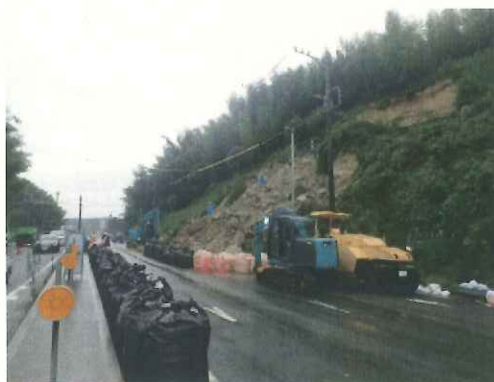
一般国道 421 号 応急対応状況
