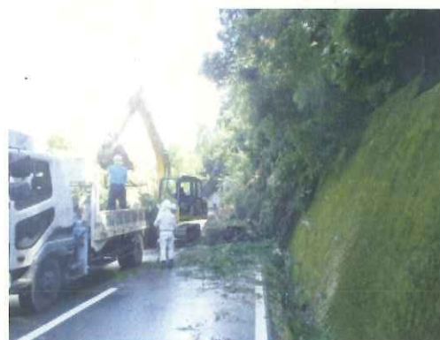
一般国道 169 号 応急対応状況
