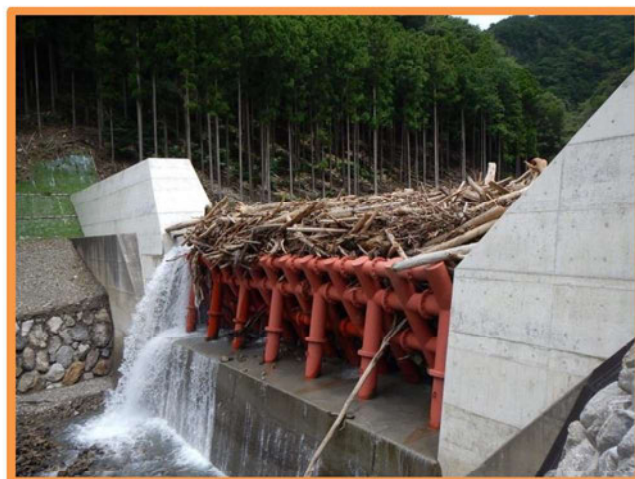
事例 1 治山施設に異常に堆積した流木
