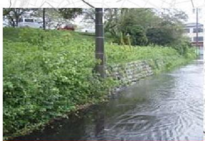
【7.2k右岸】堤防漏水
