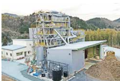
木質バイオマス発電所
