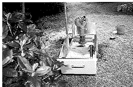
庫蔵寺防災施設（鳥羽市）
