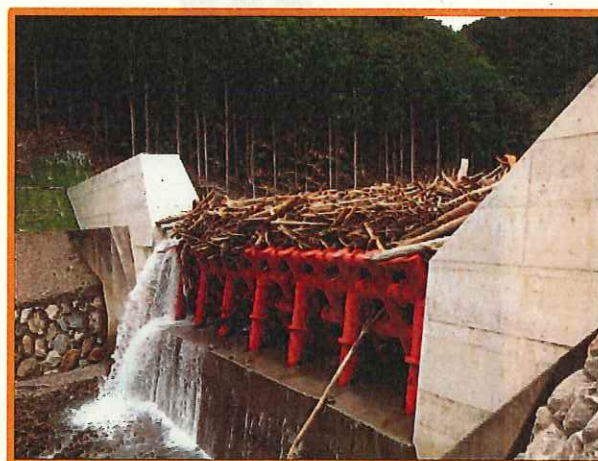
事例1 治山施設に異常堆積した流木
