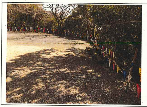
写真2 転落防止柵(実施前) ロープで囲っているのみ
