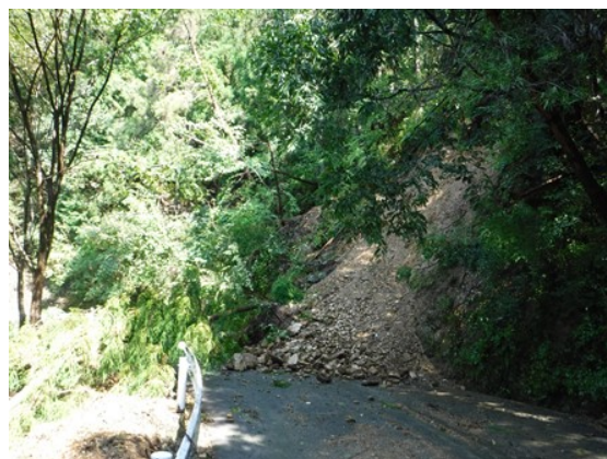
林道 有間野浦谷線 被災状況（大台町）
