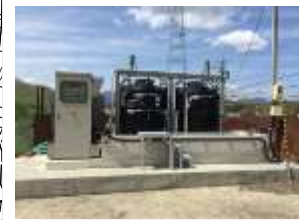
写真 霧状酸化剤注入装置
