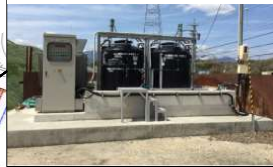
② 霧状酸化剤注入装置
