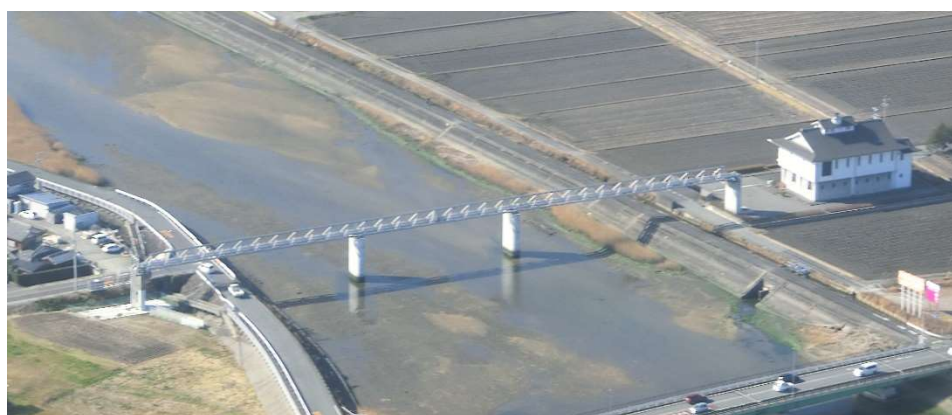
写真は松阪処理区管内の三渡川に架かる水管橋 (写真下に見えるのは国道 166 号(三渡橋))
