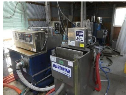
図 4. 海苔洗浄機、ミンチ機などの配置状況
