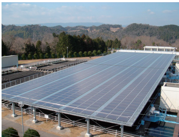
【太陽光発電設備】
