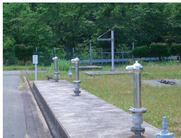
【震災時の応急給水拠点】
