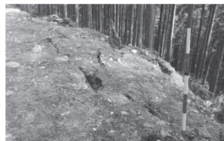
図-1. 路肩に生じた亀裂
