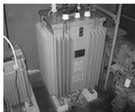
変圧器 (トランス)
