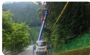
電線沿いの危険木の事前伐採
