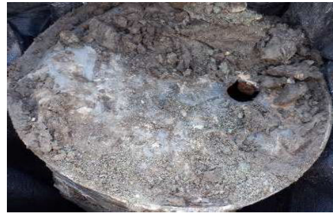
No.209ボーリング削孔跡
