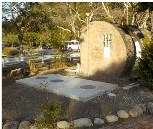
↑ 浄化槽 ちびっこ広場
