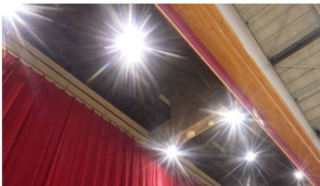
↑ 体育館（照明設備落下防止）
