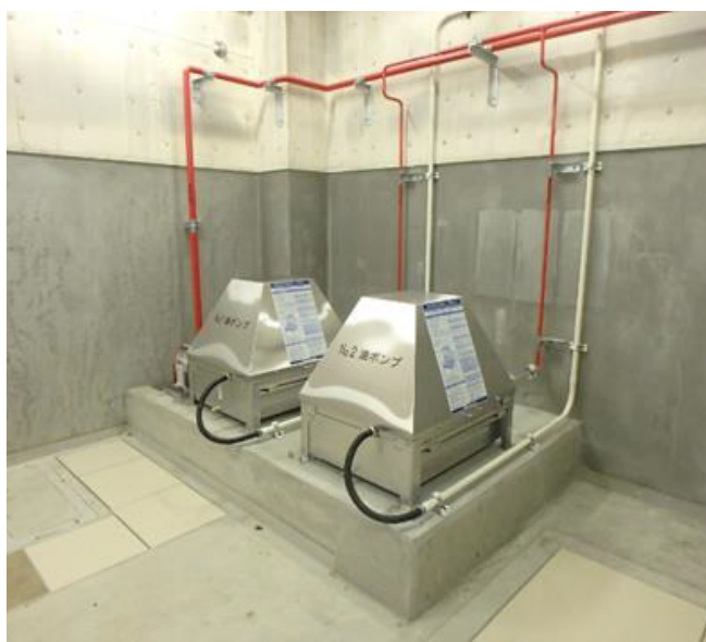
↑ 燃料移送ポンプ
