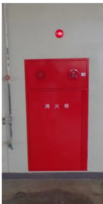
↑ 消火栓（自動車科実習棟）
