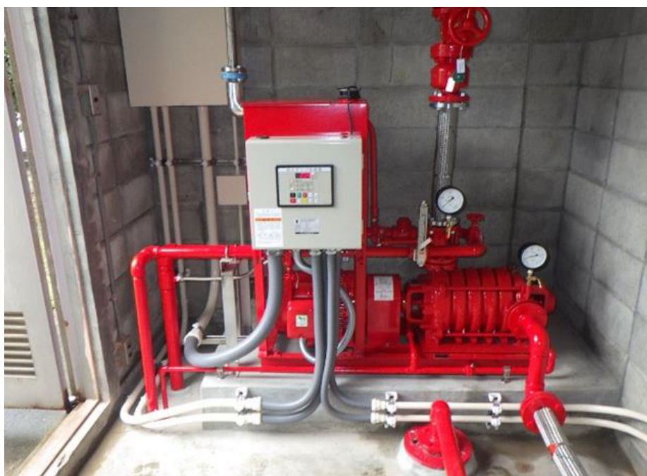
↑ 消火ポンプユニット（消火ポンプ室）
