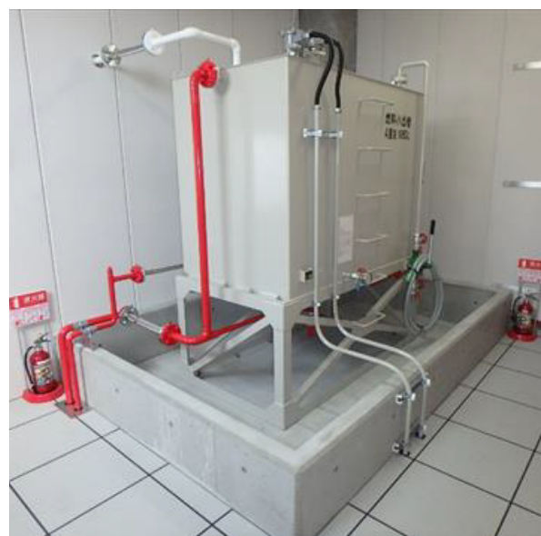
↑ オイルサービスタンク
